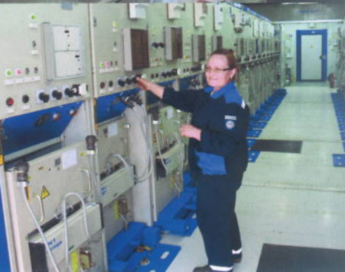
Электромонтер А.М. Вафина в зале КРУ-6 кВ
